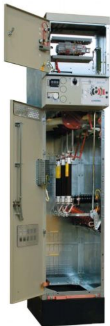
Рис.3. Ячейка с выключателем нагрузки и предохранителями
