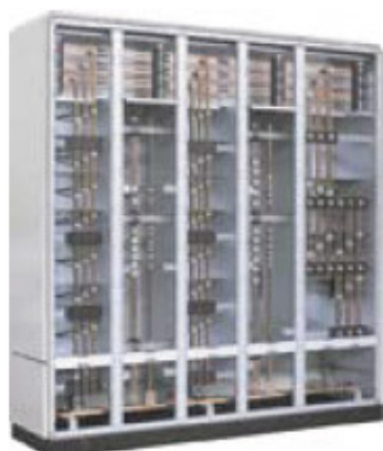
Рис. 17. Общий вид шинной системы
